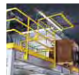
134: puerta de seguridad para mezzanine
